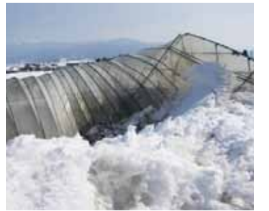
雪害で倒壊したパイプハウス
